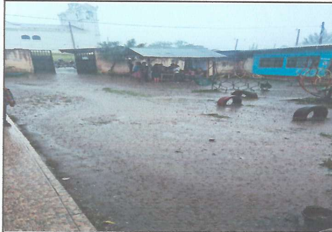
Foto 1: SE PUEDE MEJORAR EL PATIO , DE SUELO A TORTA DE CEMENTO
